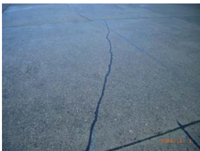
Riss in Betonplatte, saniert
